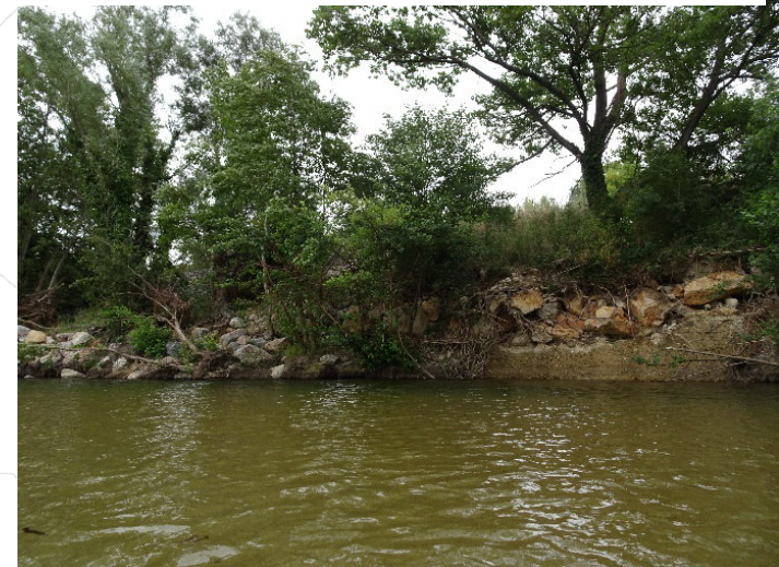
Erosion berge en rive droite (RN116)
